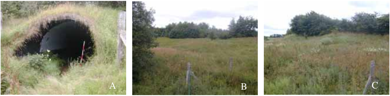
Figur B79. A: Torup Bæk, vådpassagens vestlige åbning. B: Det omgivende landskab mod nordvest. C: Det omgivende landskab mod sydøst.
