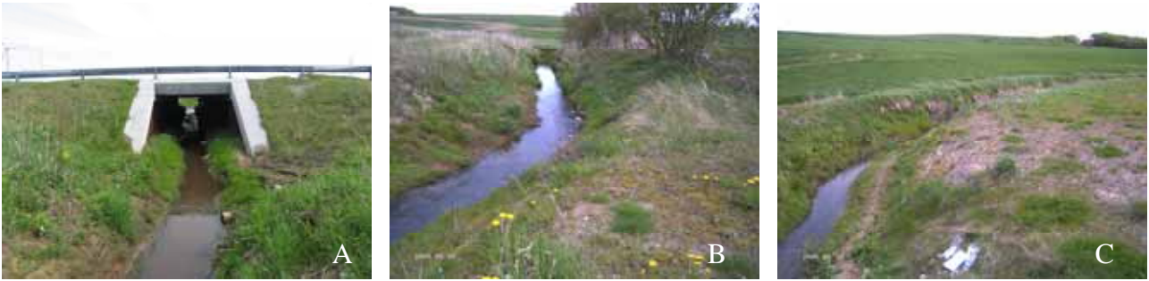
Figur B29. A: Kjul Å, vådpassagens østlige åbning. B: Det omgivende landskab mod nordøst. C: Det omgivende landskab mod sydvest.
